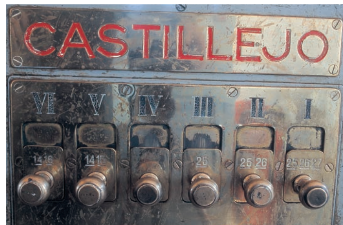
Los cerrojos de itinerario constituyen un elemento más en la seguridad de este enclavamiento.
