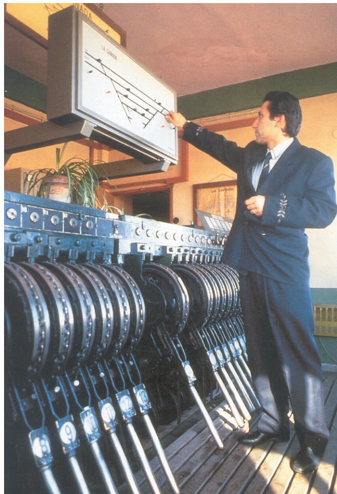
Puesto de concentración de palancas del enclavamiento de La Cañada.
