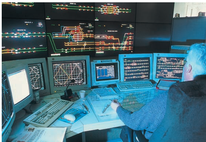
Enclavamiento electrónico en el Puesto de Mando de Madrid-Atocha.
